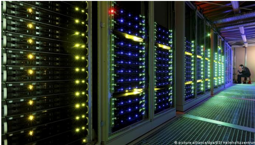
Wassergekühlte Racks des energieeffizienten Großrechenzentrums „GSI Green IT Cube“ (Bild: picture-alliance/dpa/GSI Helmholtzzentrum)
